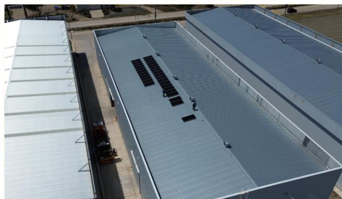
INOMAX (POLO 52) – 25 kWp CÓRDOBA, ARGENTINA.
